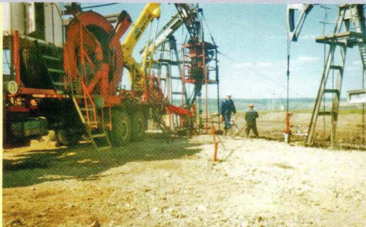
Рис. 1. Работа по межтрубному пространству с установкой М10 Д=38,1 мм Fig. 1. Servicing via annular space with CTU M10, with 38.1 mm O.D. tubing.
