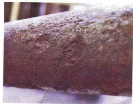
122-й метр трубы. На рисунке показана точечная коррозия. На основе замеров глубина составляет 0,7 мм.
