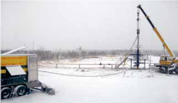
Рисунок 3 – Удаление воды с забоя газовой скважины месторождения Комсомольское, ПКС-5Г с ГСПТ 38 мм, глубина отбора 950 м, давление в скважине 30 атм (2009 год) (ООО «ТехСервис ЗЛТ»)
