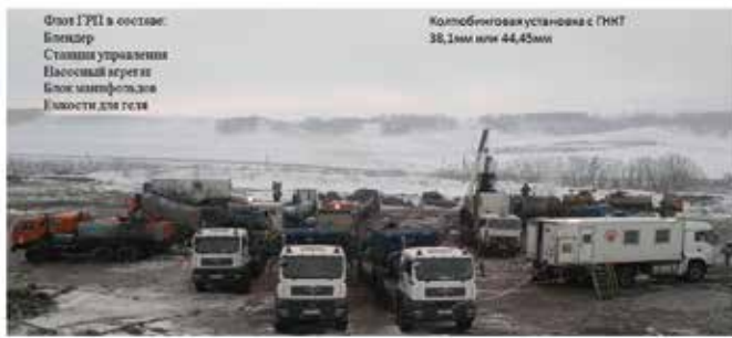
Используемое оборудование для проведения технологии ГПП + ГРП с использованием ГНКТ
