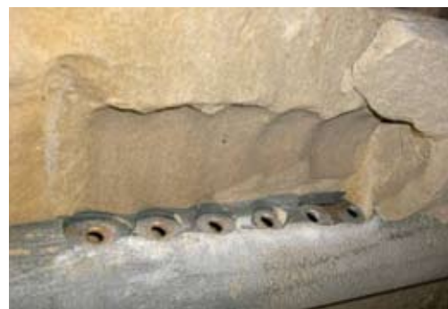
Рисунок 6 – Каверны, образующиеся в заколонном пространстве
