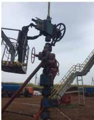
Установка гидравлического превентора
