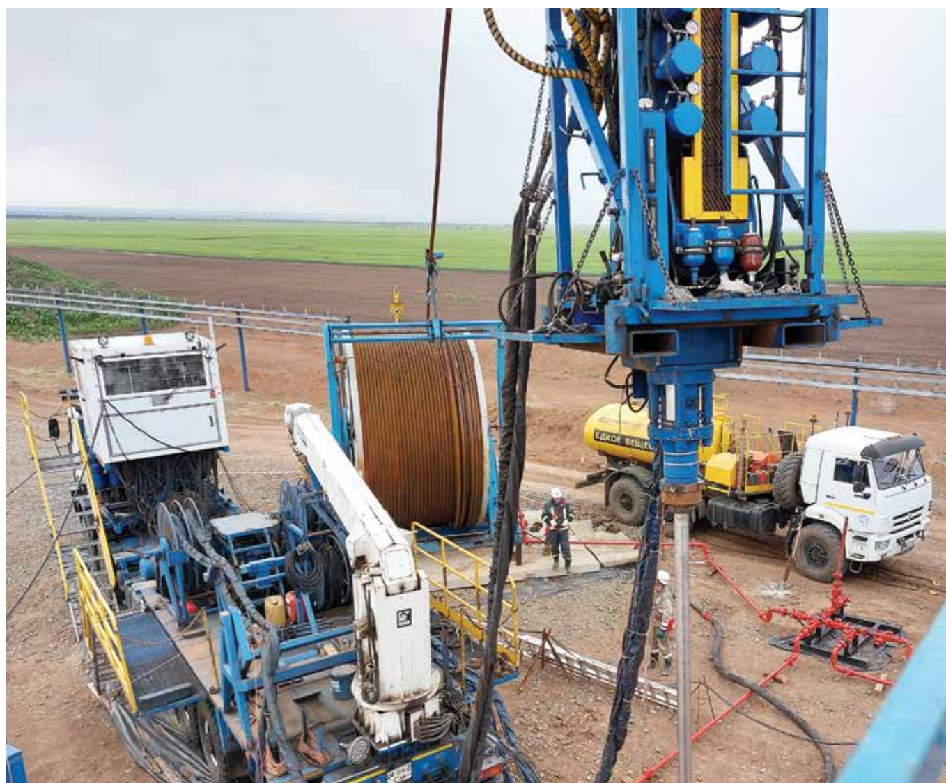
Рисунок 1 – ГНКТ 73 мм со смонтированной КНБК, установка ГНКТ, узел намотки, блок глушения и инжектор грузоподъемностью 45 т
