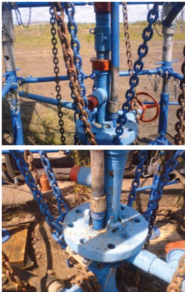
Рисунок 3 – Обвязка устья скважины Figure 3 – Wellhead setup
