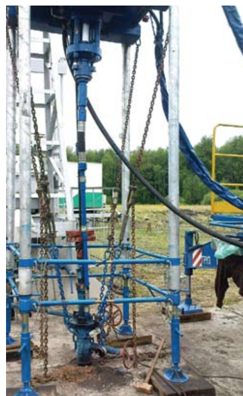
Рисунок 2 – Устье скважины, подготовленное для проведения работ по межтрубному пространству Figure 2 – Wellhead prepared for annular space operations
