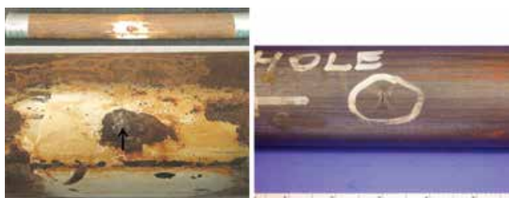
Рисунок 12 – Отверстия, расположенные в двух разных местах на внешней поверхности одной и той же гибкой трубы Отверстие № 1 – слева, отверстие № 2 – справа Figure 12 – Pinholes on the External Surfaces at 2 Different Locations Within the Same CT String Pinhole #1 on Left, Pinhole #2 on Right
