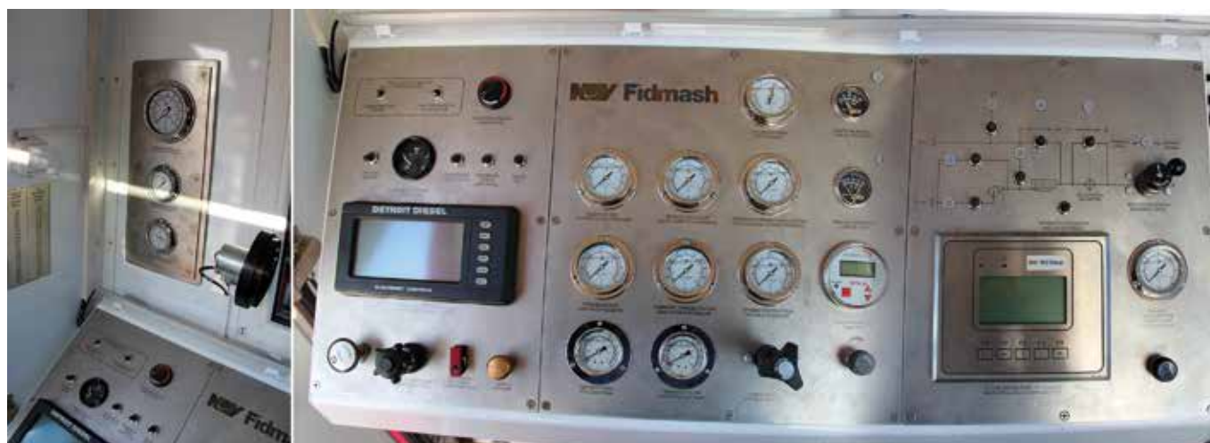
Рисунок 6 – Пульт управления в кабине оператора Figure 6 – Control panel in operator's cockpit
