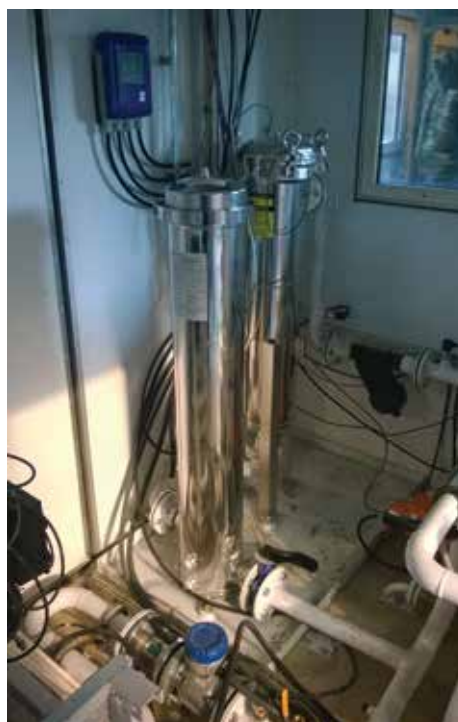
Рисунок 7 – Установка УНП9. Система подготовки воды
