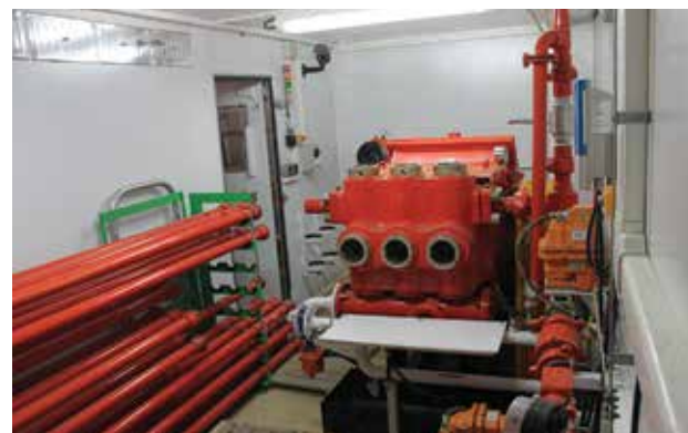
Рисунок 3 – Установка УНН2. Вид на насос высокого давления
