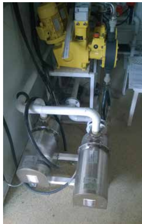
Рисунок 8 – Установка УНП9. Выходные центробежные насосы и система дозировки жидких химреагентов
